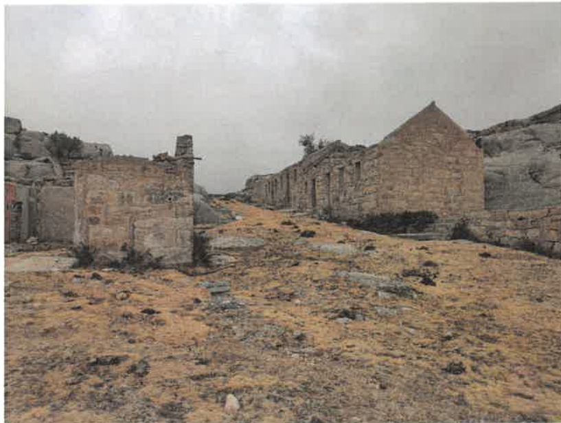
Edificado em ruínas – Mina de Carris
