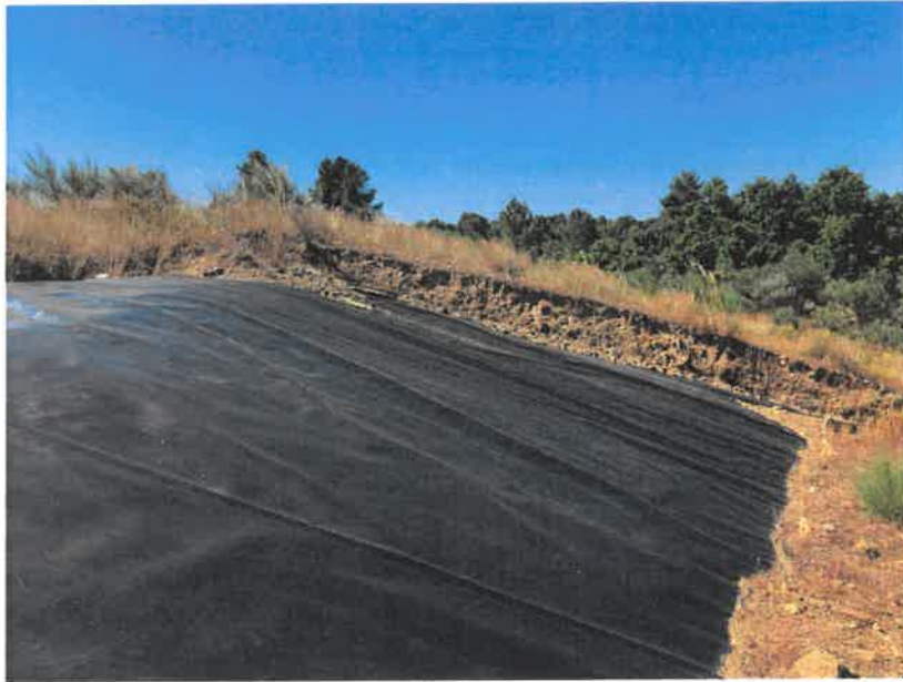
Pormenor do escorregamento dos terrenos de coberturas da célula de confinamento da área mineira de Senhora das Fontes
