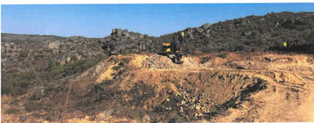
Processo de remoção e saneamento de solos e escombrelras (Barrôco do Ouro)
